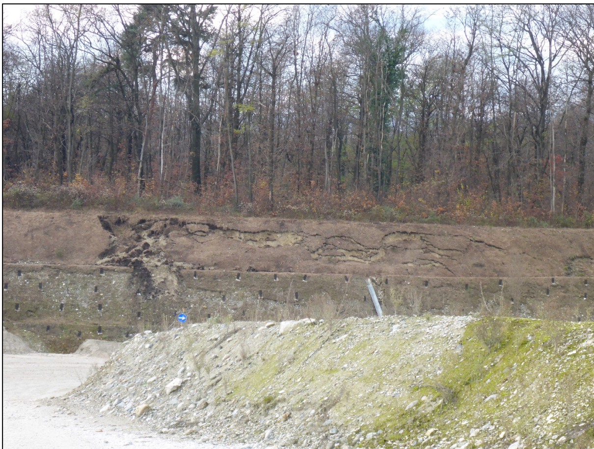
Figura 4.5 – Fronte lato est della miniera, zona meridionale; si notano i dissesti superficiali che interessano i fronti dei gradoni.
